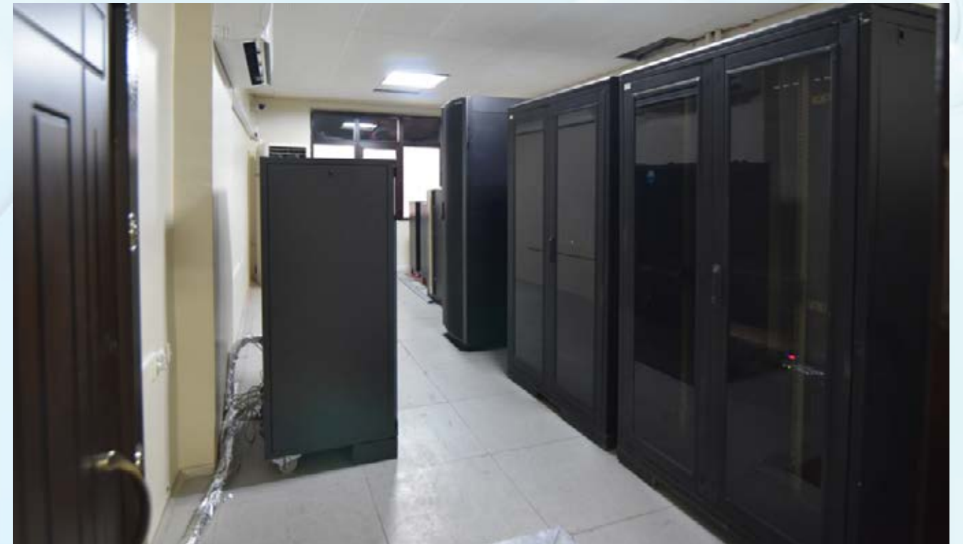
Merkez Bina Sunucu Odası
