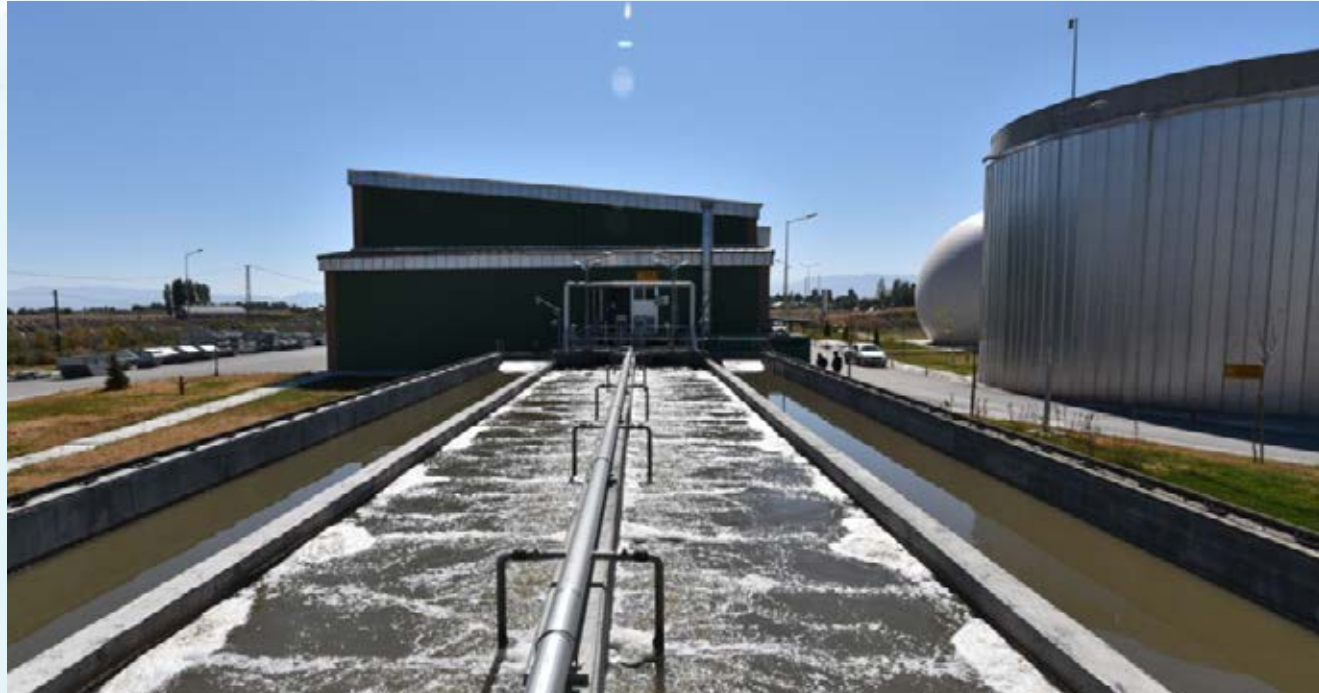
Havalandırma Kum ve Yağ Tutma Havuzu
