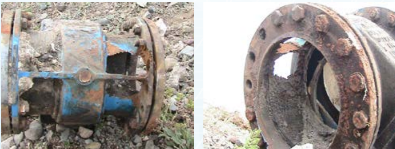
Değiştirilen Çürük Vanalar
